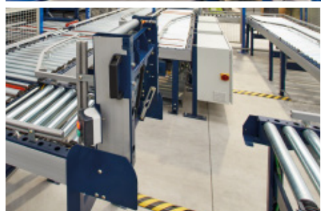
Un convoyeur abattable a été installé afin de faciliter les mouvements des opérateurs.
